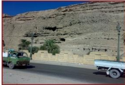
صورة (18) توضح مدى اقتراب الحافة الشرقية التي تنتشر بها حفر التافوني من الطريق ومدى خطورتها عليه في حالة انهيار الكتل الصخرية من حفر التافوني. التصوير صوب الشرق.
